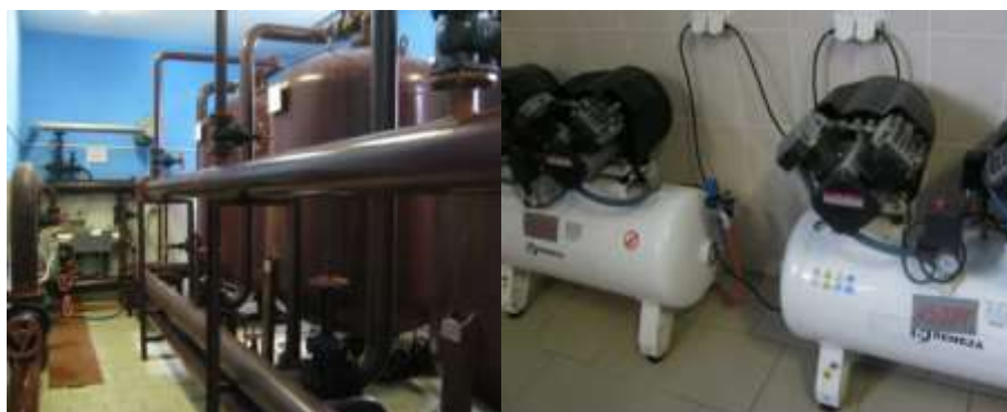
Рисунок 29. Станция обезжелезивания г. Островец
