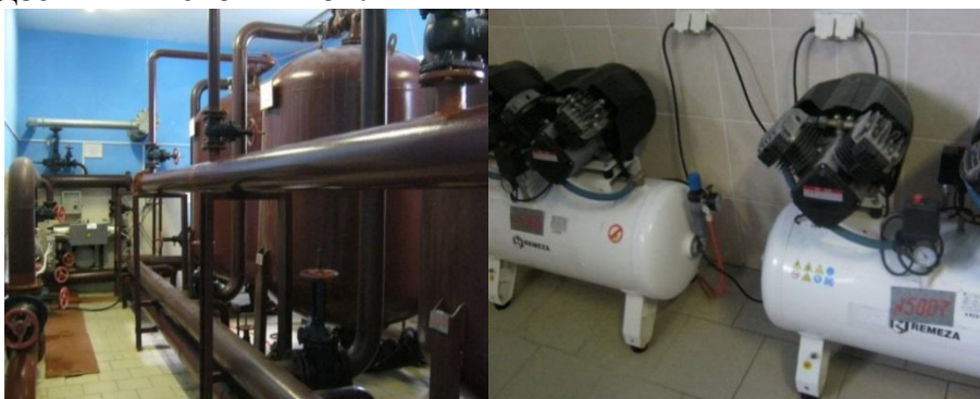
Рисунок 26. Станция обезжелезивания РУП ЖКХ г.Островец
